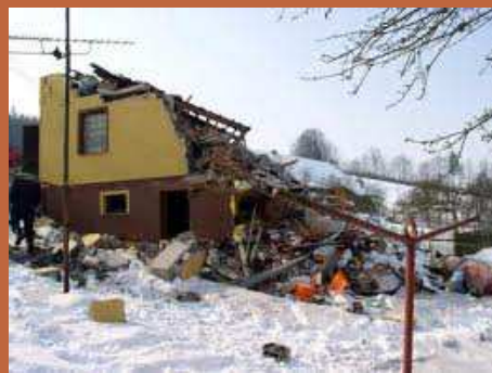
Důsledek nesprávného připojení tlakové lahve (propan-butan) k zařízení (trouba).
