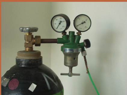
1. Hlavní ventil (na bombě) je zavřený, jehlový ventil je vytočený dolů, vypouštěcí je zavřený.
